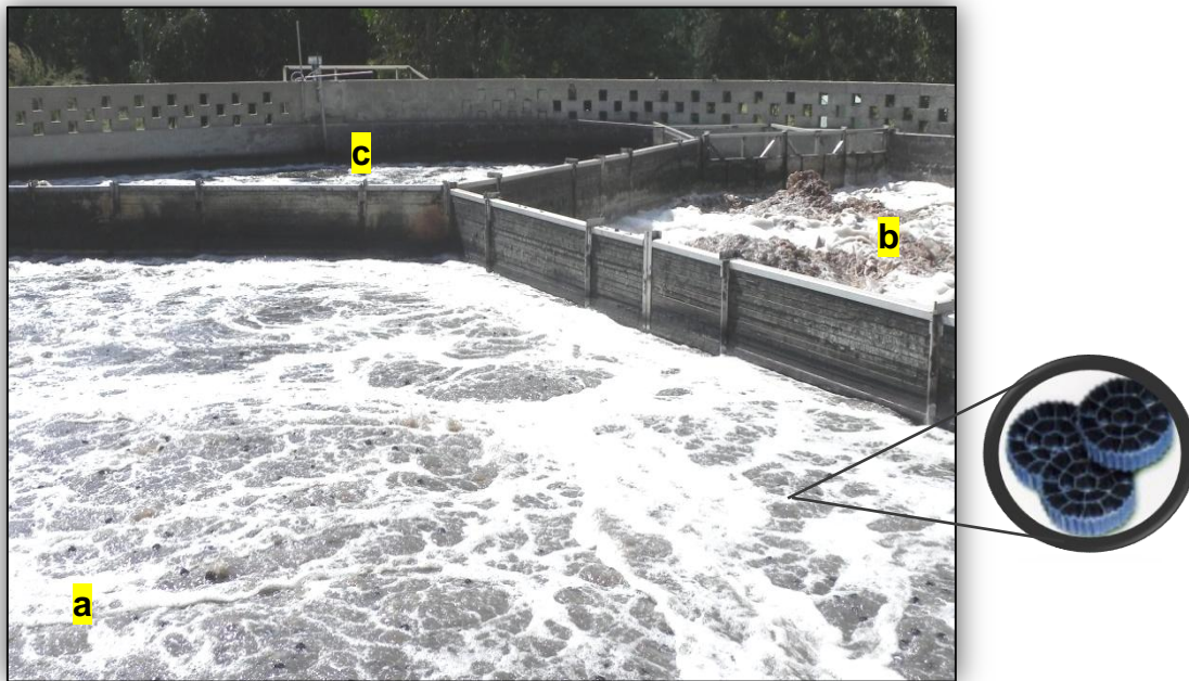
Figura 1.14. Reactor de tratamento aeróbio com 3 compartimentos: a/b - são do tipo MBBR (destaque na imagem) e c - faz a recirculação de lamas activadas (CAIMA, 2011).
