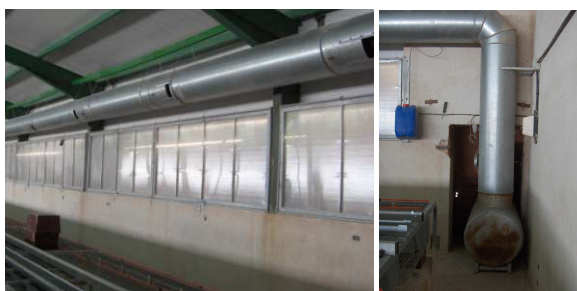
Figura 8: Queimador, gerador de ar quente e respectiva conduta
