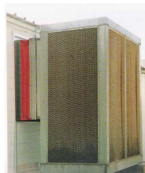
Figura 7: Painel com ventilador acoplado
