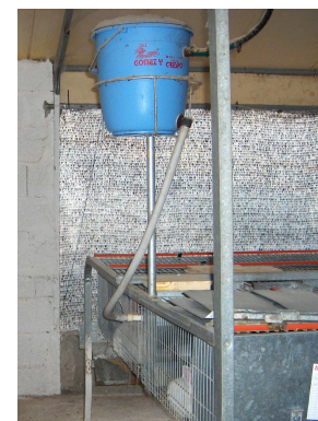
Figura 23: Depósito de água
