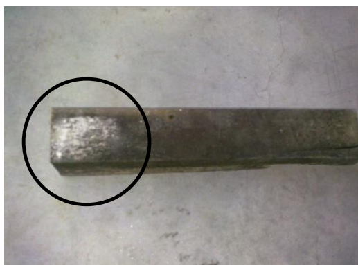
Figura 3.5 – Zona atacada por fungos na amostra de barrote da cobertura (Junho de 2012)
